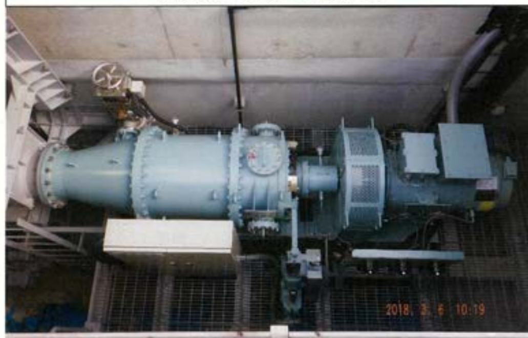
ふくしま北部配水池発電所 横軸前口フランシス水車
